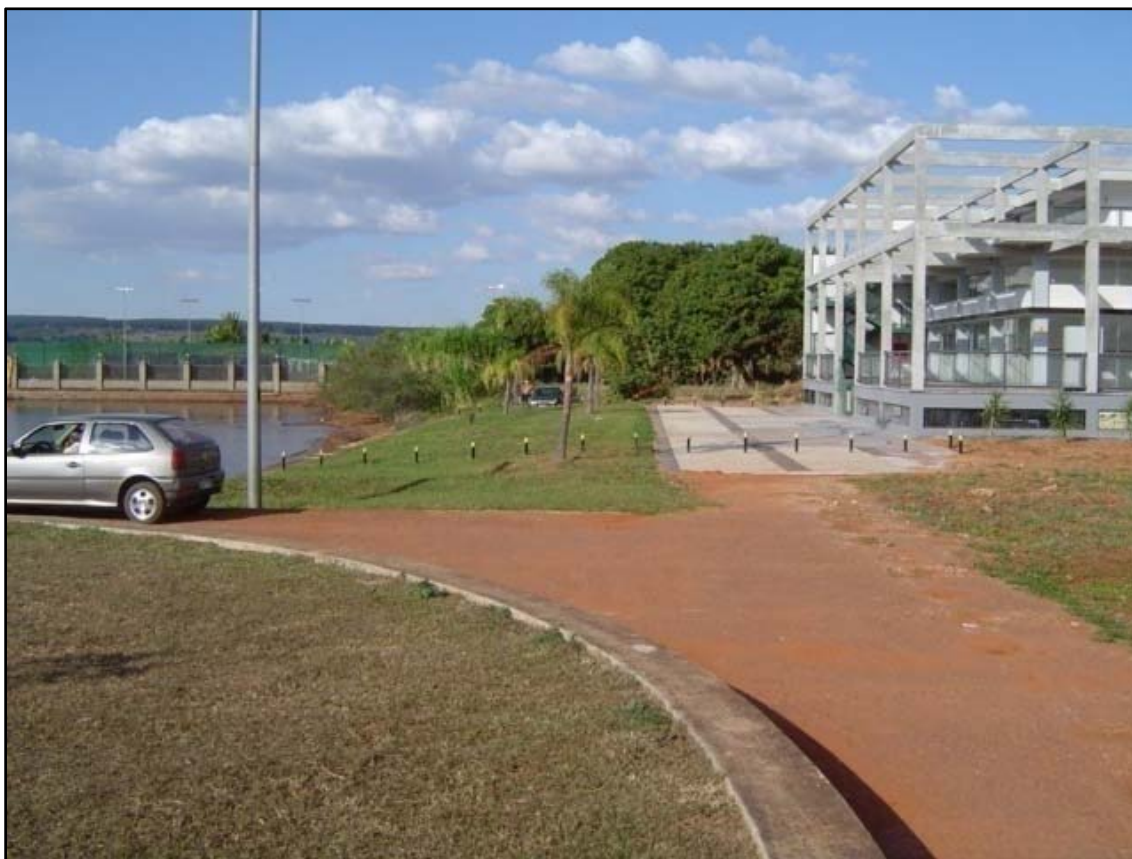
Figura 51 - Um edifício em construção dentro da margem de 30 metros de recuo obrigatório, no Pólo 3.
